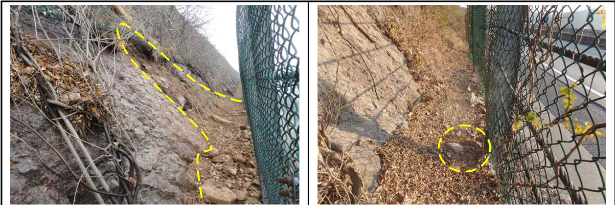
‘12년 상반기 기 점검이후(낙석 제거완료) 소규모 낙석(경미) 일부 발생(Sta. 238.450km)
