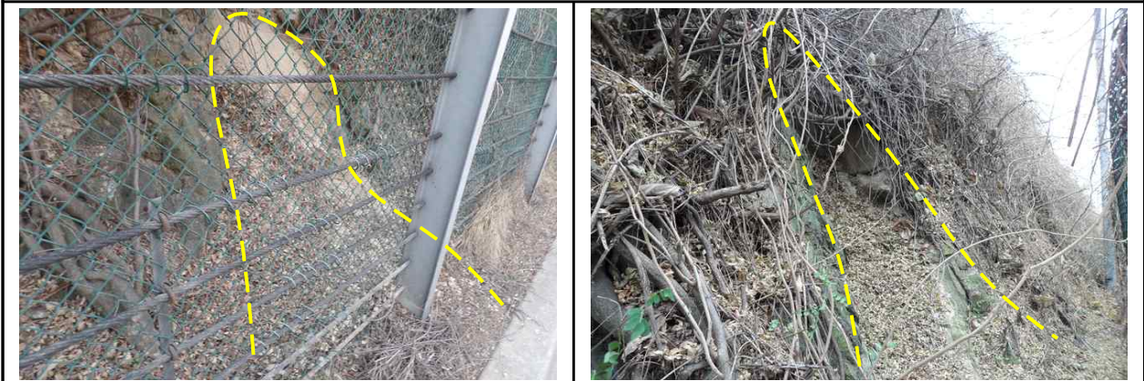
‘16년 상반기 기 점검이후(토사 제거완료) 추가손상 없음(Sta. 233.870km)
